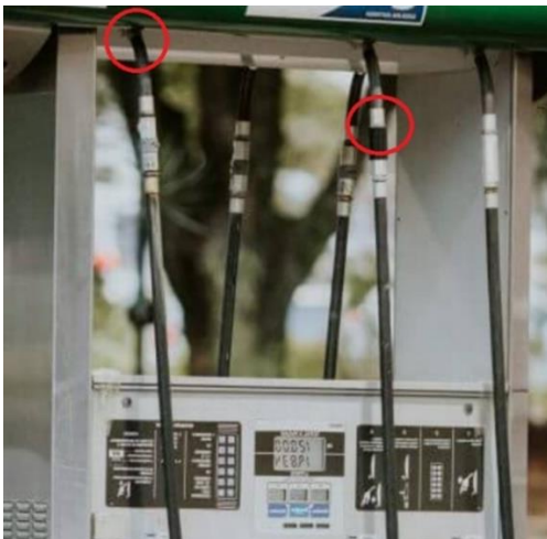
Figura 6 - Locais de instalação na saída das bombas de combustíveis.
