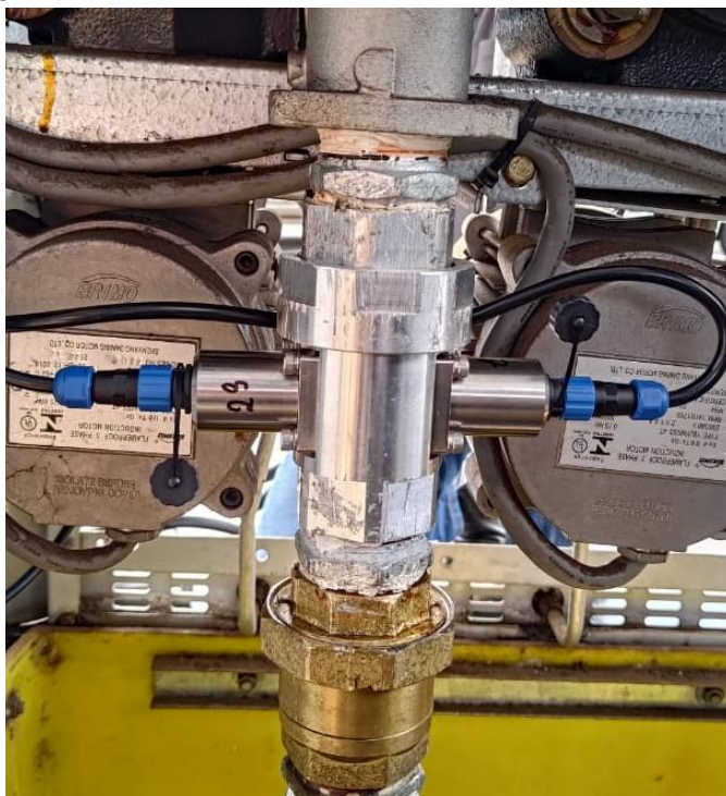
Figura 7 - Locais de instalação na entrada das bombas medidoras
