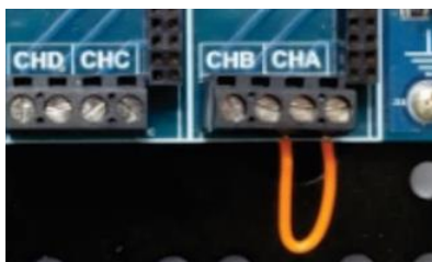
Figura 26 - Curto circuito no Canal A para medição da corrente do módulo
