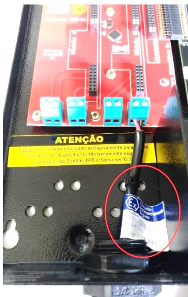
Figura 21 - Fixação e identificação do cabeamento IS
